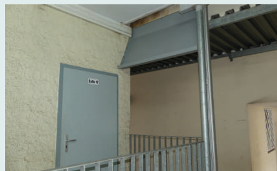
La gouttière sur mesure de la deuxième école.
