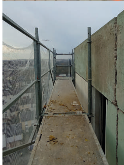
Figure 4 - Échafaudage muni d'un filet, sous la corniche, ce regroupement de noctules a hiberné deux mois pendant les travaux de curage
